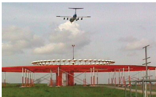
图 6-10 VOR 地面导航台
